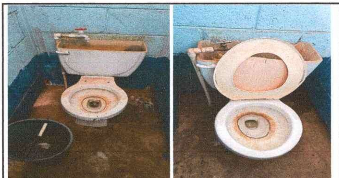
Foto 5: Se observa el modulo de inodoros en mal estado
